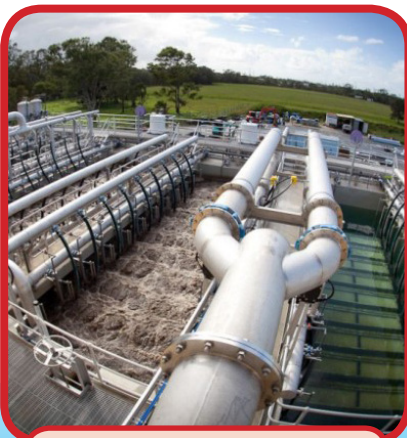
Ballina WTP membranes.
